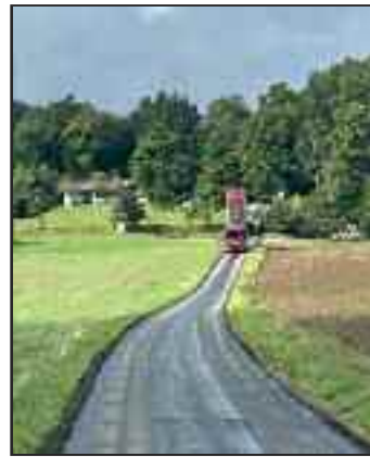
Nachdem die Arbeiten am Unterbau abgeschlossen waren, erhielt der gesamte Feldweg eine neue Asphalttschicht.
