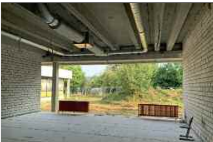
Bis auf die Heizkörper und die Zwischenwände blieb in den Klassenzimmern nichts weiteres erhalten.
