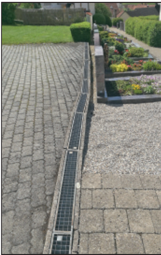
Die vorhandene Entwässerungsrinne hat sich im Laufe der Zeit deutlich verschoben
