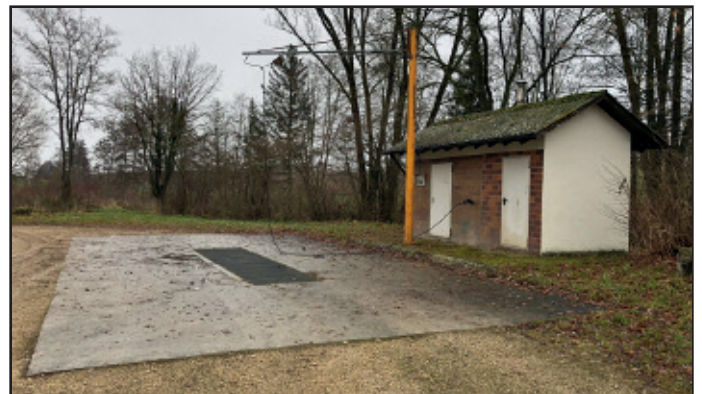
Zur Ertüchtigung der Waschanlage wären umfangreiche Maßnahmen notwendig
