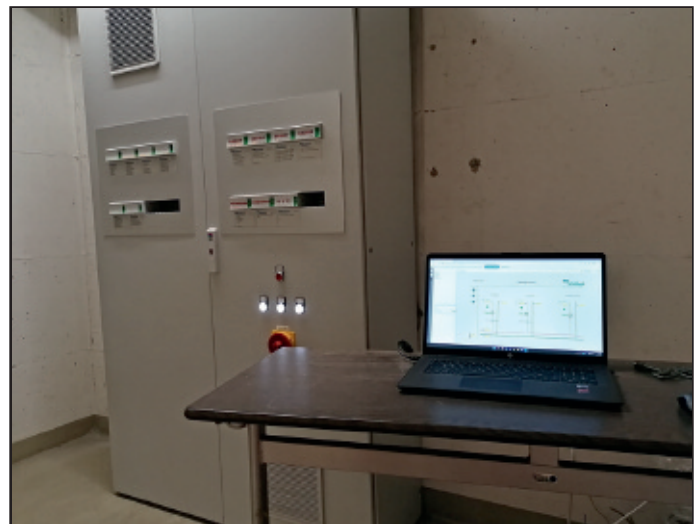
Die neue Steuerung ermöglicht eine optimale Regelung der Heizung und Lüftung
