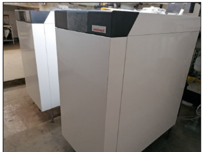
Die neuen Gasbrennwertkessel sind deutlich platzsparender als die alten Ölkessel
