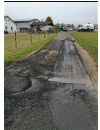
Unliebsame Überraschung durch fehlenden Unterbau im Bereich „Dinkelläcker“ im Ortsteil Billafingen
