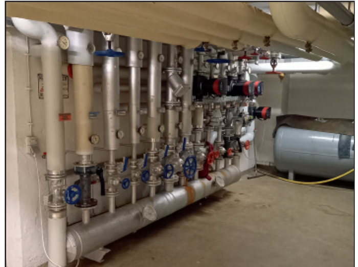
Die alte Heizungsverteilung im Keller der Turn- und Festhalle
