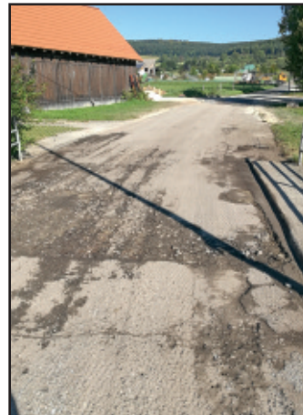
Im Vorfeld der Asphaltanierung musste der schadhafte Asphaltbelag im Bereich der Traubengasse entfernt werden
