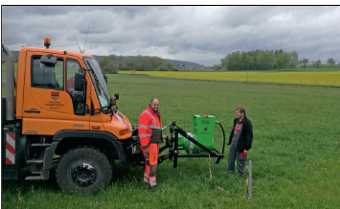
Wassermeister Dirk Schmidt sowie Lorenz Scham von der Firma Emhart beim Testbetrieb des neuen Notstromaggregates
