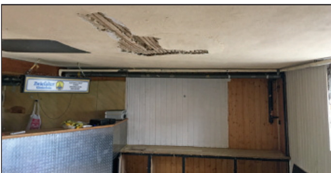
Im Deckenbereich des Jugendraums löste sich großflächig der Putz
