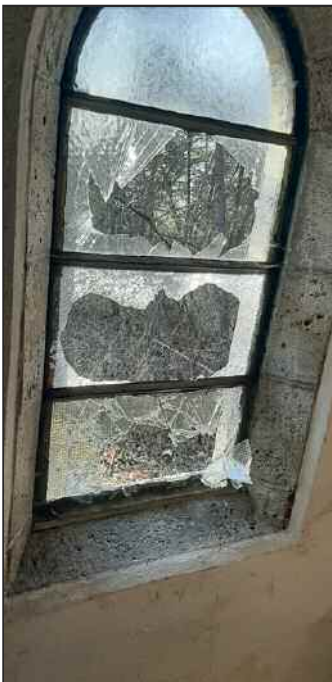
Beschädigte Scheiben an der Eichbergkapelle.
