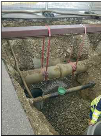
Der Anschluss des neuen Schmutzwassersammlers an den Schmutzwasserkanal in der Enhofer Straße war etwas kompliziert.
