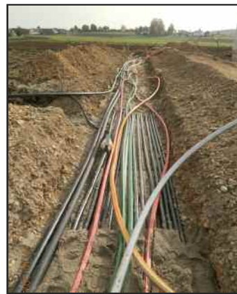
Für die neuen Stromkabel und die Breitbandleerrohre musste ein entsprechend breiter Graben hergestellt werden.
