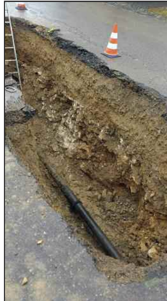
In der Gammertinger Straße im Ortsteil Ittenhausen war wiederum ein größerer Aufwand notwendig, um den Wasserrohrbruch zu beheben.
