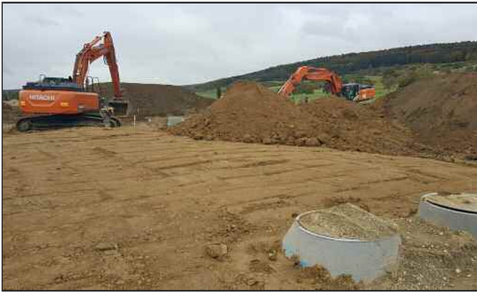
Aufgrund der guten Witterung kamen die Tiefbauarbeiten zügig voran Leerrohre an die bestehende Breitbandtrasse
