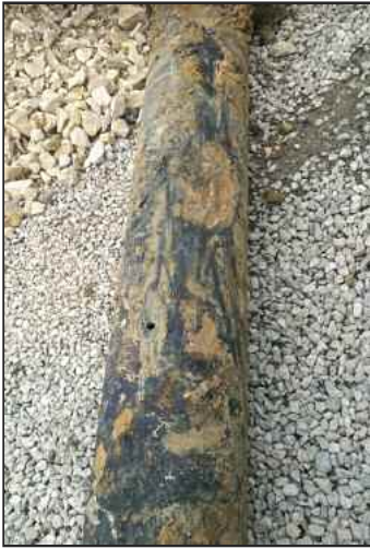
Starker Lochfraß an der Hauptwasserleitung in Emerfeld
