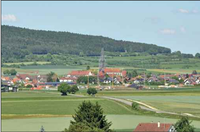
Unmittelbar nach Fertigstellung der Erschließungsarbeiten wurden 7 Baukräne für private Bauvorhaben aufgestellt (Foto: Josef Reck)
