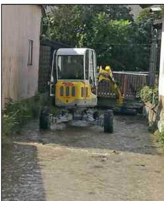
Mit einem speziellen Bagger erfolgte die Sohlräumung in der Ortsmitte von Andelfingen
