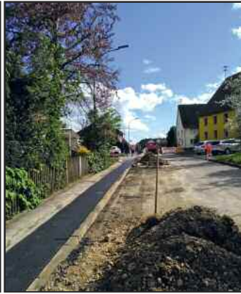
In der Ortslage von Emerfeld erfolgte bereits eine Mitverlegung von Breitbandleerrohre zum späteren Anschluss der einzelnen Haushalte
