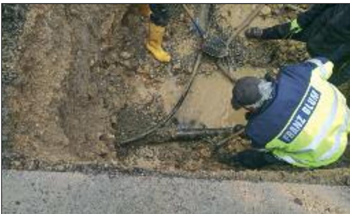
Mehrere größere Schadstellen machten einen Komplettaustausch der Leitung erforderlich
