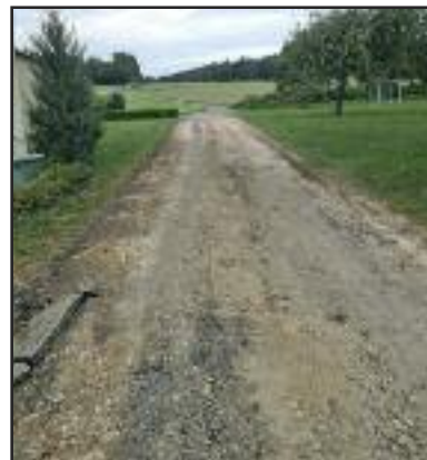
Nach dem Abfräsen des Asphaltbelages kam der mangelhafte Unterbau zum Vorschein
