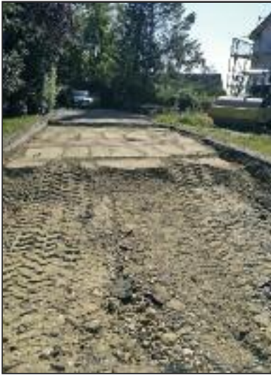
Fehlender Unterbau ebenfalls im Eichertweg
