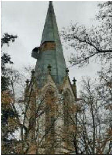
Gefährliche Situation am Kirchturm der St. Konradskirche
