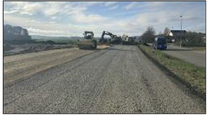
Zur Anlegung eines Linksabbiegers wurde die bestehende Landstraße im Bereich des neuen Baugebiets verbreitert
