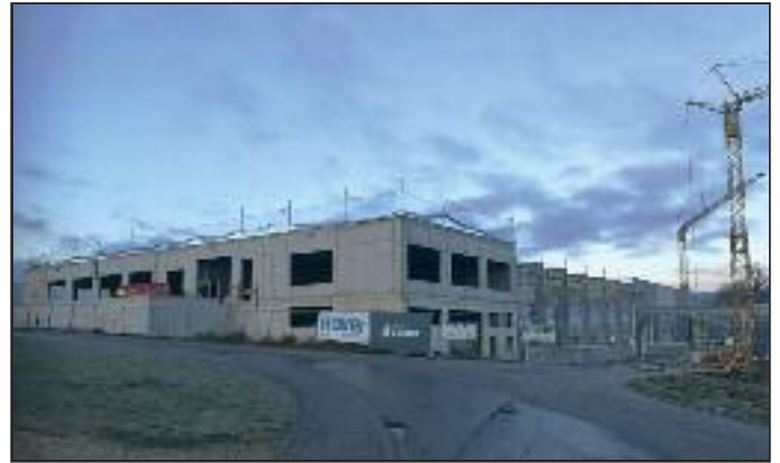
Gigantische Ausmaße des neuen Lager- und Logistikzentrums
