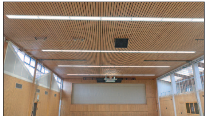
Neue LED-Lichtbänder in der Turn- und Festhalle Langenenslingen
