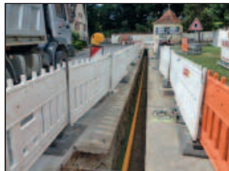
Tiefbau im Zuge der Gaserschließung in der „Enhofer Straße“ im Ortsteil Wilflingen
