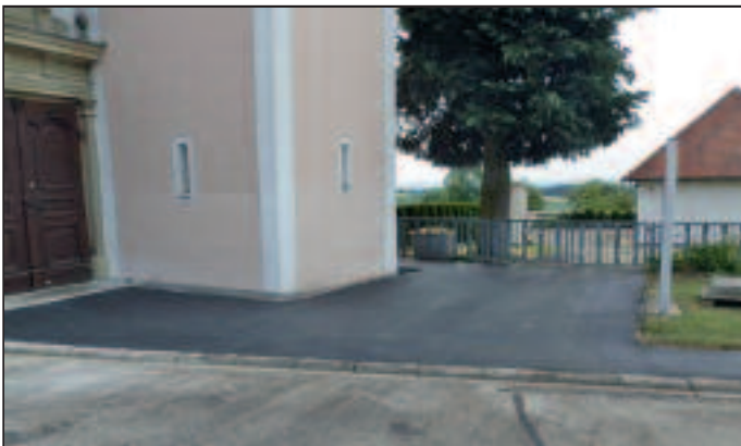
Neue Asphaltfläche im Zugangsbereich zur Kirche und zum Friedhof im Ortsteil Billafingen.
