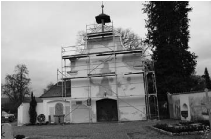
Der Putz musste an der Westseite der Friedhofskapelle in Wilflingen ausgebessert werden.
