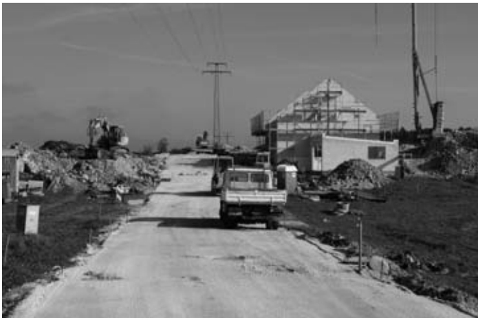
Der Straßenkoffer für die Erweiterung im Baugebiet „Brühl“ ist eingebaut – auch mit dem Bau eines Wohnhauses wurde begonnen.
