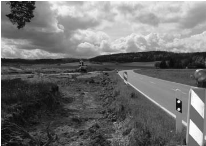
Beginn der Arbeiten für die Anlegung eines Retentionsbeckens entlang der L415 für das Gewerbegebiet.
