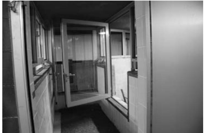
Die beiden Kammern des Hochbehälters in Wilflingen sind nun durch Glasscheiben vom Zugangsbereich abtrennt.
