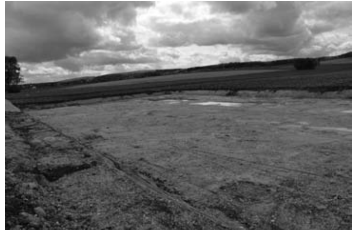
Die kaum gegebene Versickerungsmöglichkeit machte den Bau eines großen Retentionsbeckens für das Gewerbegebiet notwendig.
