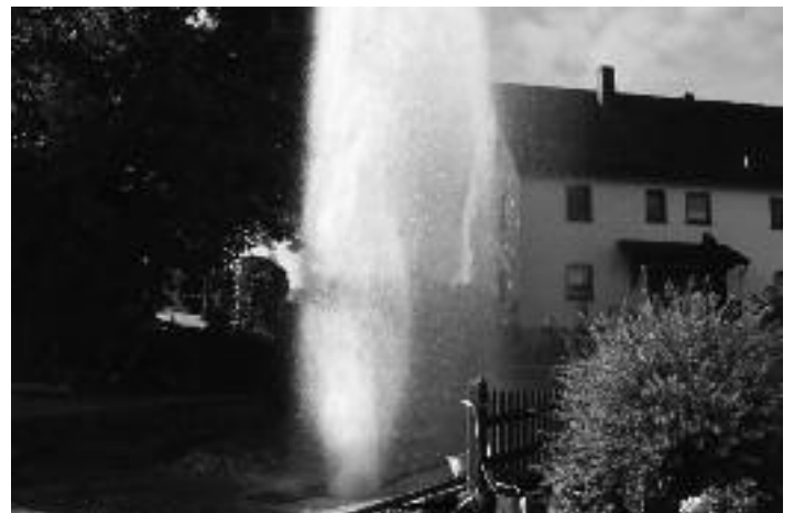
Bei den Bauarbeiten an der „Bitzstraße“ wurde eine Leitung angerissen – hoch war die Fontäne aus der Wasserleitung
