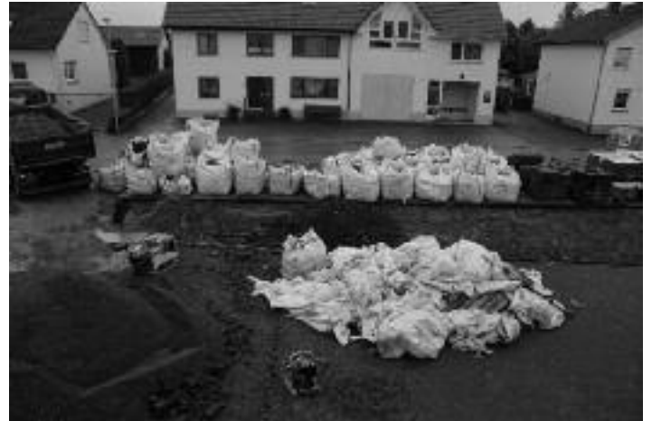
Leere und noch gefüllte Säcke mit Pflastersteinen für den Rathausbereich in Langenenslingen.
