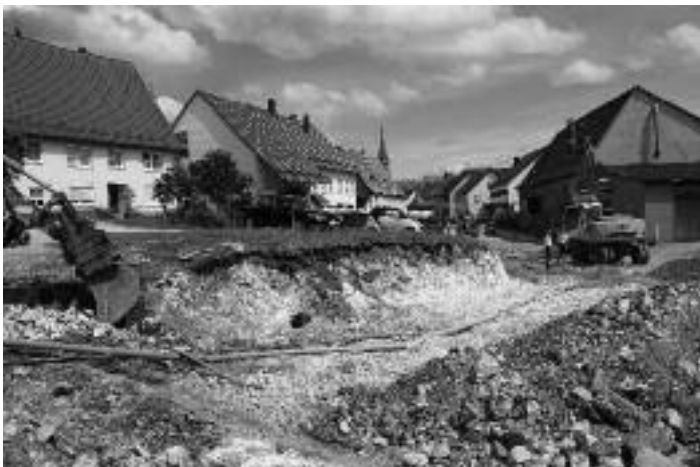
Schwerer Fels war an der Schattenweiler Straße in Langenenslingen bei der Baustelle Hauptstraße herauszubrechen.
