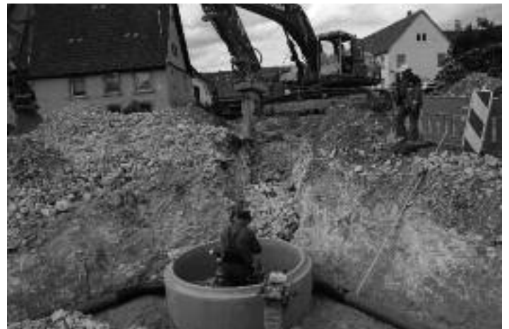
Der Graben für die Wasserleitung musste am Bühlen in Langenenslingen ebenfalls herausgemeißelt werden.
