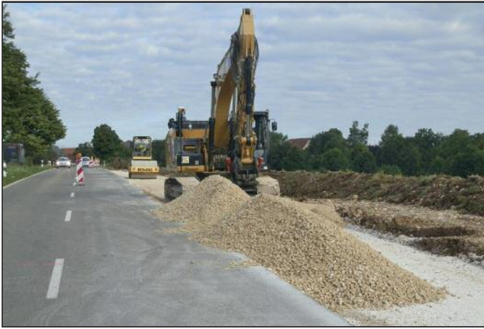
Die Bauarbeiten in Bezug auf die Einrichtung einer Linksabbiegespur beim Gewerbeareal dieser Abbiegespur vollständig übernimmt. Das örtliche Bauunternehmen Franz Blum wurde mit dieser Maßnahme beauftragt. Somit steht nun eine ordnungsgemäße und ausreichende Zufahrt zum betreffenden Gewerbebetrieb bereit.
