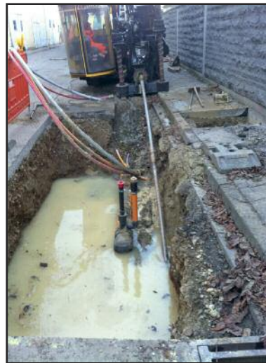
Schwierige Spülbohrung am Gasthaus „Eck“ zur Verlegung der Gasleitung unter der Hauptstraße hindurch
