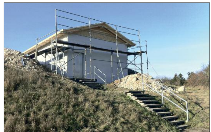
Die Bauarbeiten hinsichtlich des neuen Satteldaches sowie der Wärmedämmung an den Außenwänden des Hochbehälters Wilflingen sind fast abgeschlossen
